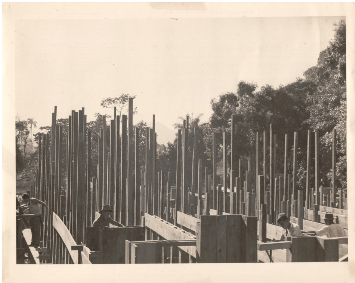
Operários trabalham na construção do Edifício Cardeal Leme. 1953. Fotógrafo desconhecido. Acervo Núcleo de Memória da PUC-Rio.
