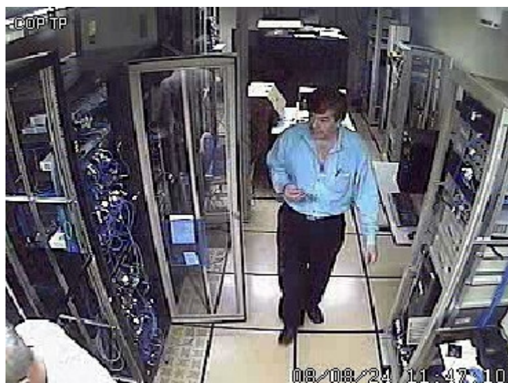
agosto de 2008 - Telles na ativação do novo "no-break" (imagem obtida das câmeras de segurança do RDC)
